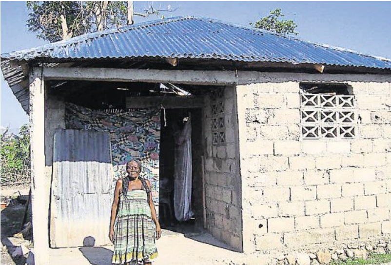
Le toit de la maison d’Eugénie avait été arraché par l’ouragan Matthew.
